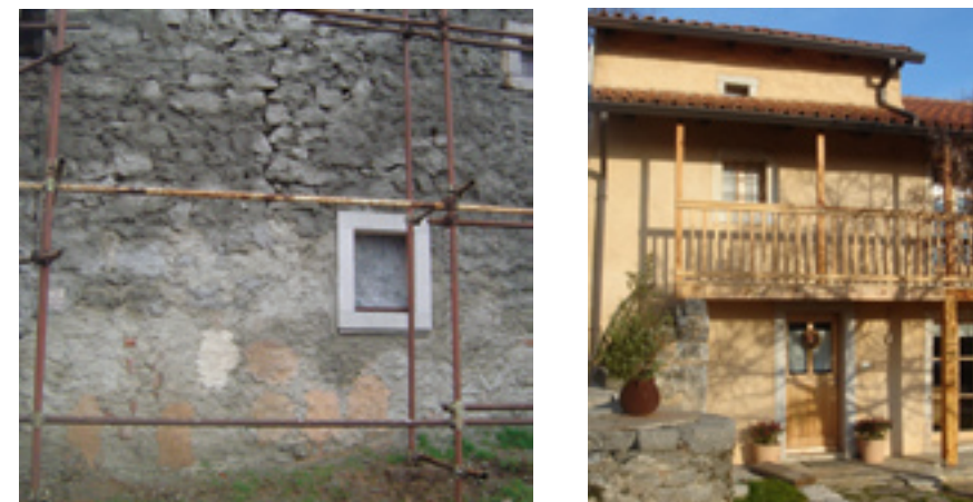
Prikaz priprave vzorcev za določitev najprimernejše sestave nove, tonirane apnene malte (levo) ter izvedena nova apnena fasada. Avtor fotografij: Nataša Kolenc
