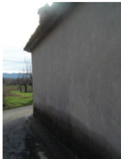
Streha brez žlebov in nepravilno izveden stik stavbe s tlemi omogoča pronicanje velikih količin vlage direktno v steno stavbe.
